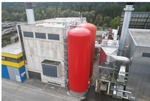
Der Pufferspeicher im Biomasseheizkraftwerk Lienz wird erweitert.
